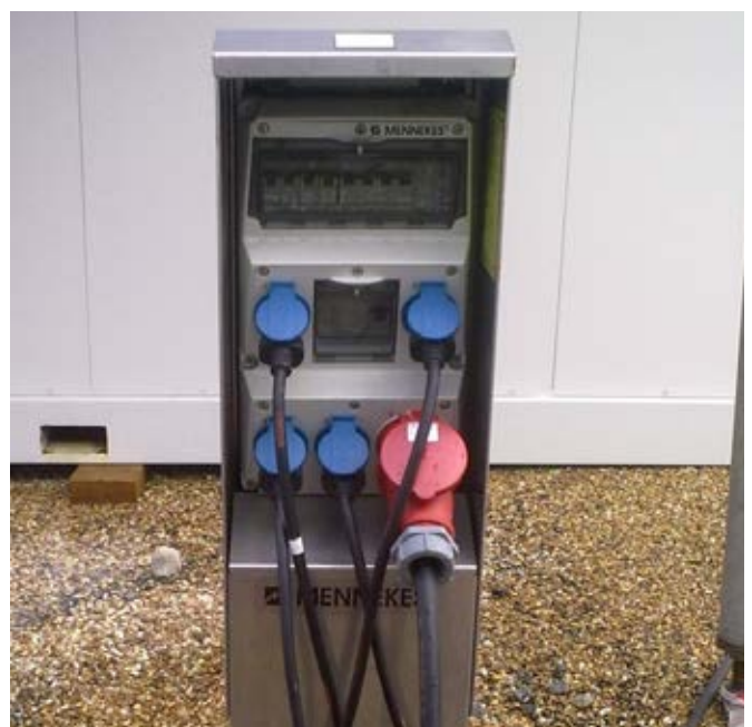
Borne d'alimentation plate-forme logistique, Le Havre - France
